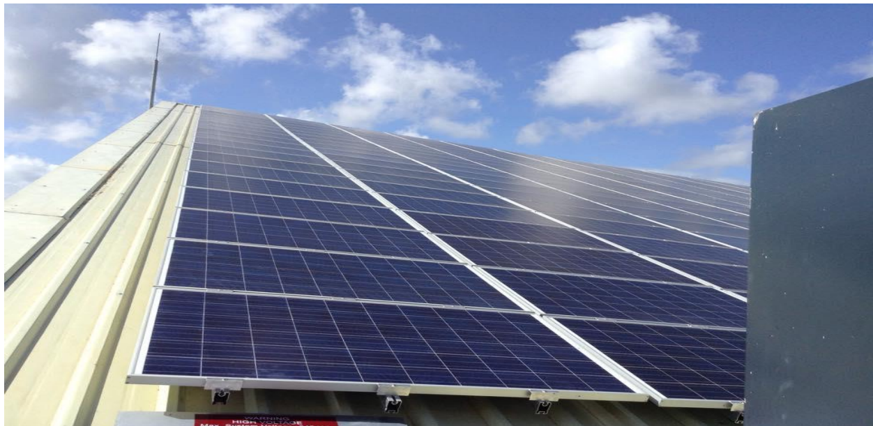
Puerto Princesa solar rooftop
