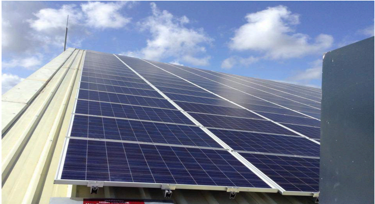
Puerto Princesa 78 kw Solar Rooftop
